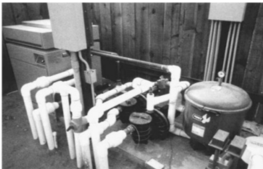
شکل (۹-۲) نمونه‌ای از تجهیزات نصب شده استخر یا جکوزی
